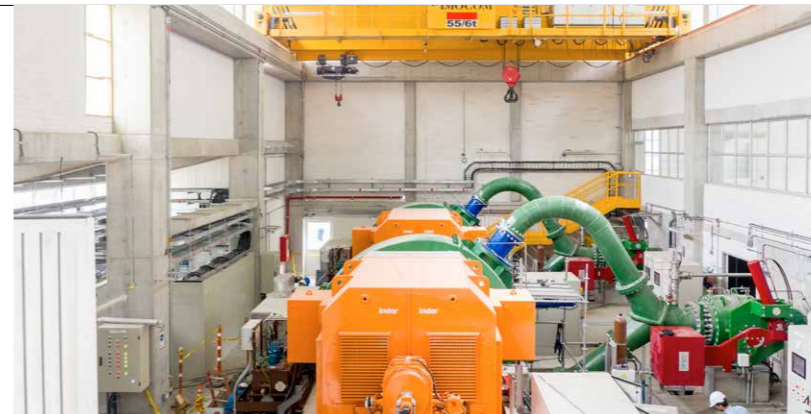
Pequeña Central Hidroeléctrica San Andrés de Cuerquia Antioquia, Colombia
