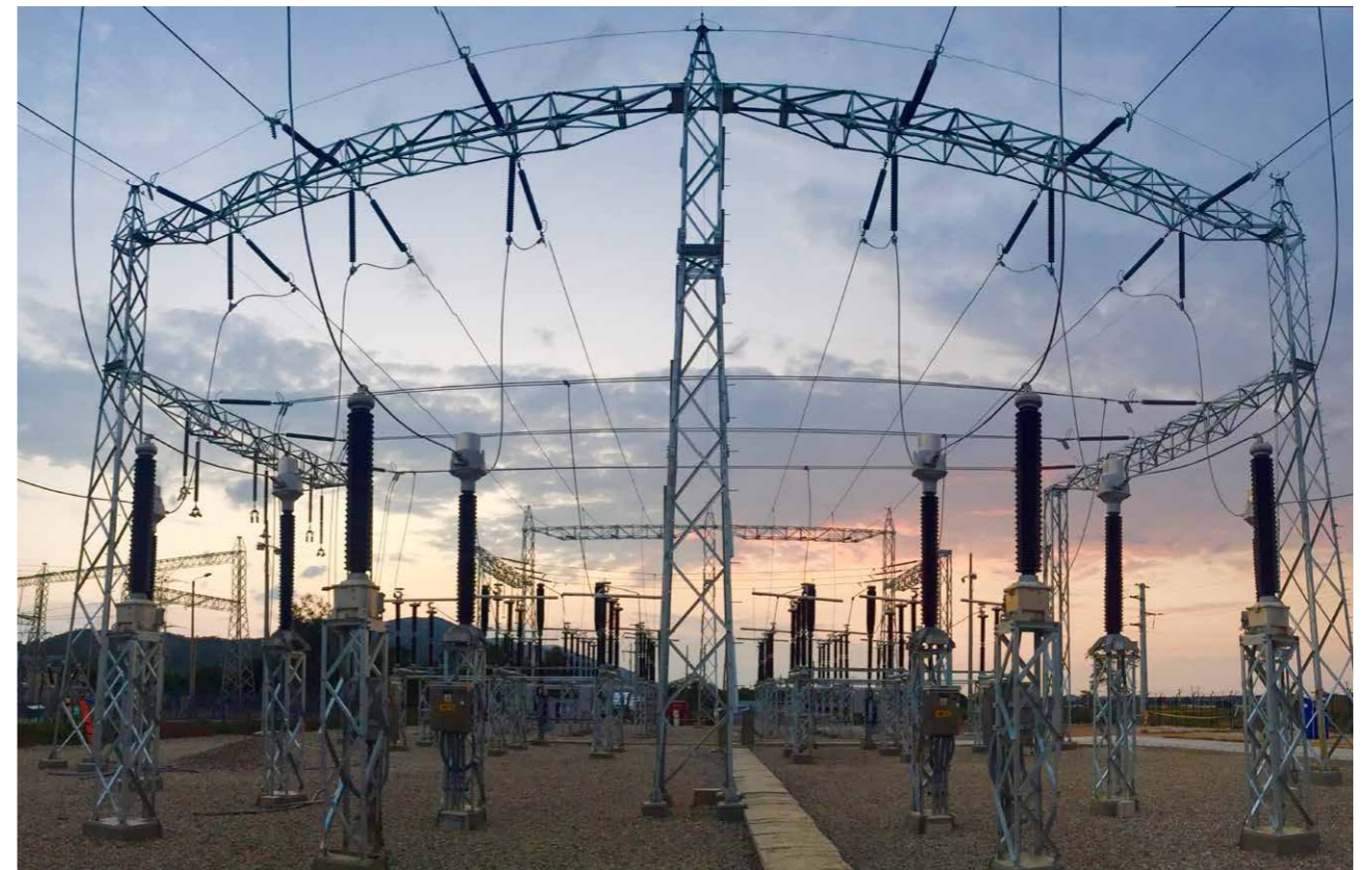
Subestación Cuestecitas La Guajira, Colombia
